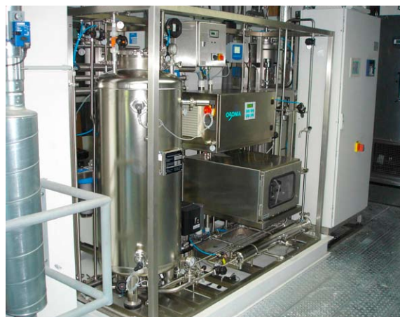
Highly Purified Water mit Ozonoisierung bei der Wilhelm Werner GmbH Quelle: Wilhelm Werner GmbH
